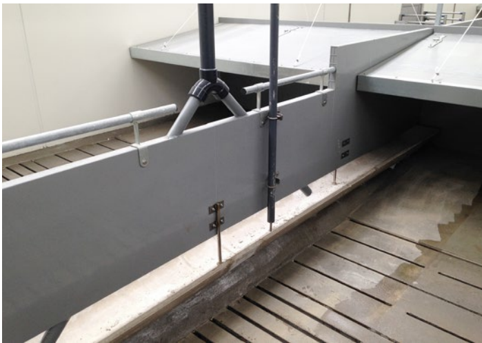
Mastschweinebucht mit integriertem Flüssigfütterungsrohr
