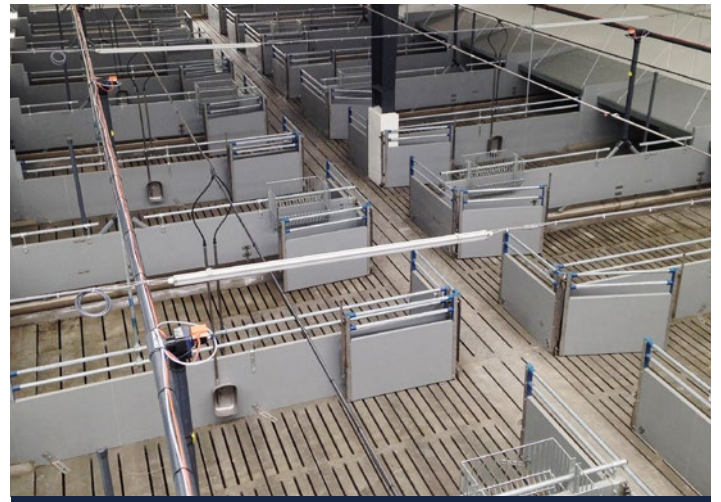
FRATS-stier med små låger og centralt opluk af overdækning
