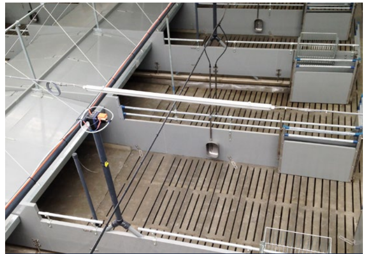
Wean-to-Finish-Bucht mit integrierter Flüssigfütterung
